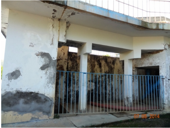
Foto 01 – Presença de perda de revestimento.
