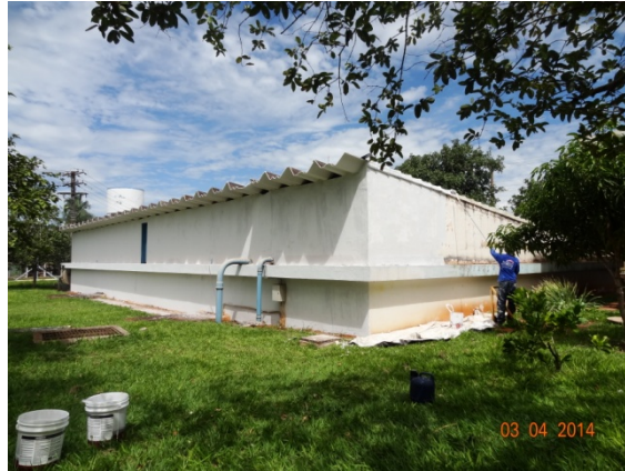
Foto 1: Infiltração sendo eliminada
