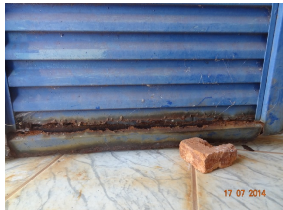
Foto 4 – Corrosão na porta
