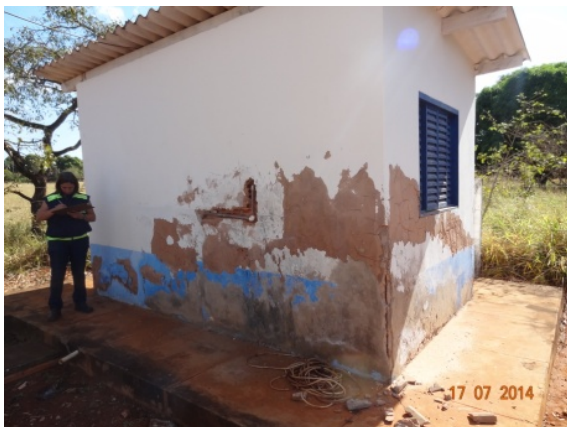
Foto 3 – Perda de revestimento
