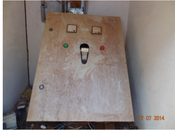
Foto 2 – Quadro de comando solto
