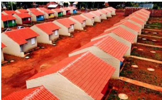
São 50 moradias a custo zero em fase final de construção em Iporá
