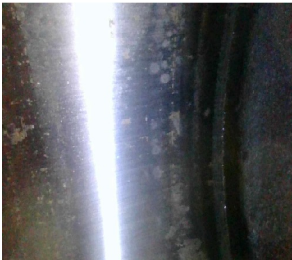
Parede interna da câmara de combustão com muita ferrugem
