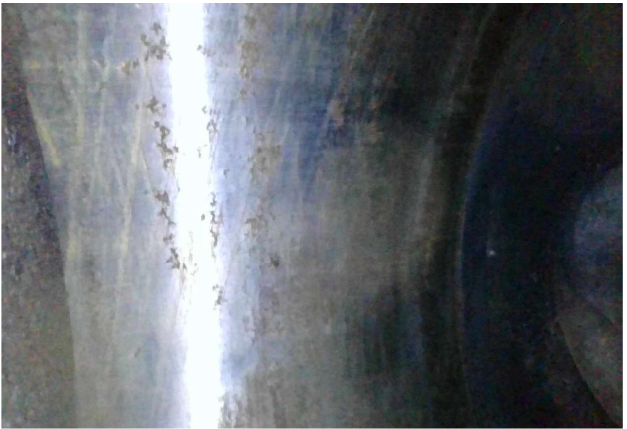
Câmara de combustão com ferrugem
