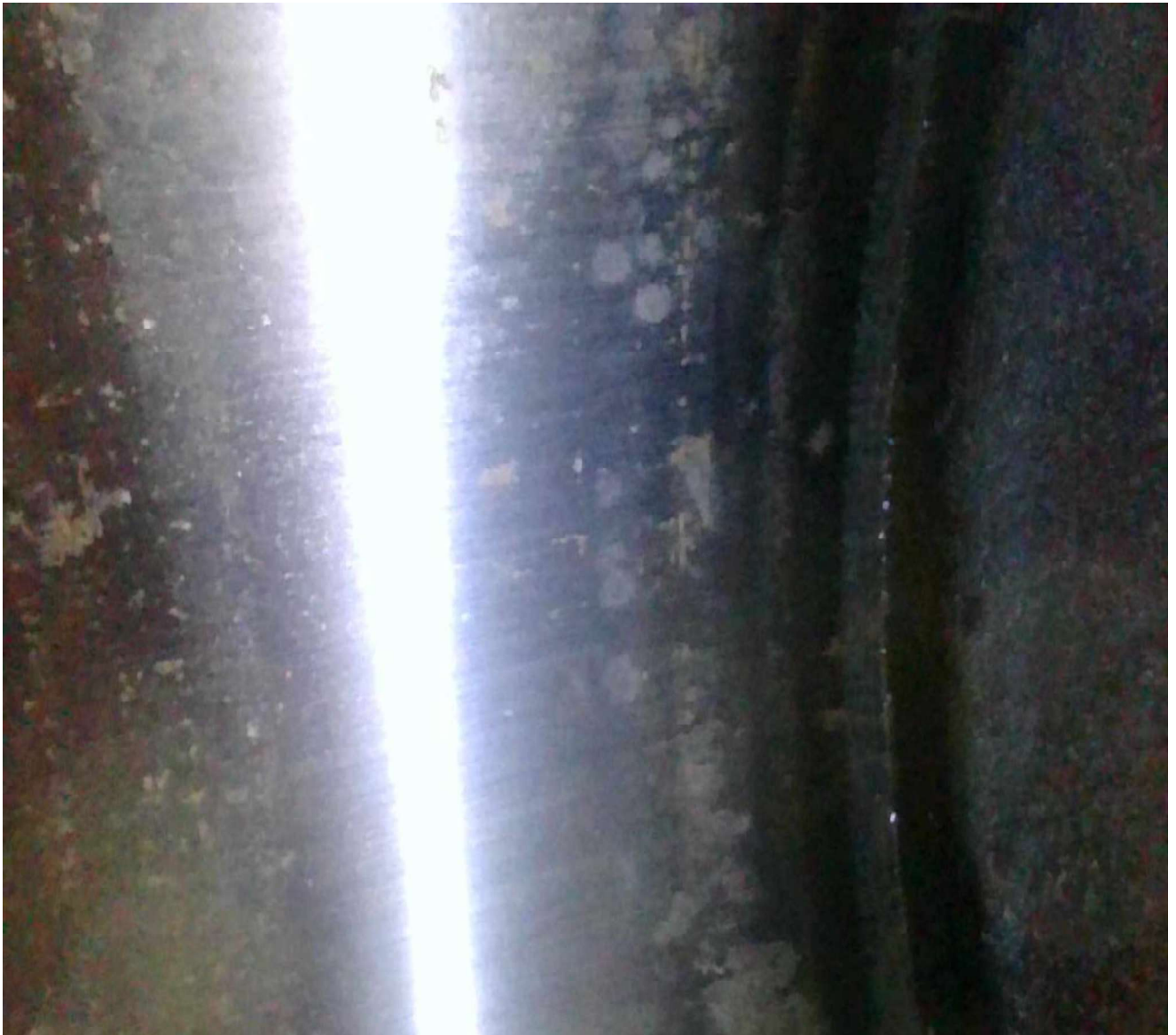
Parede interna da câmara de combustão com muita ferrugem
