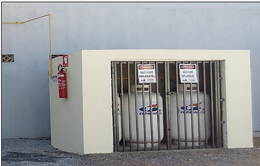
Central de gás GLP
