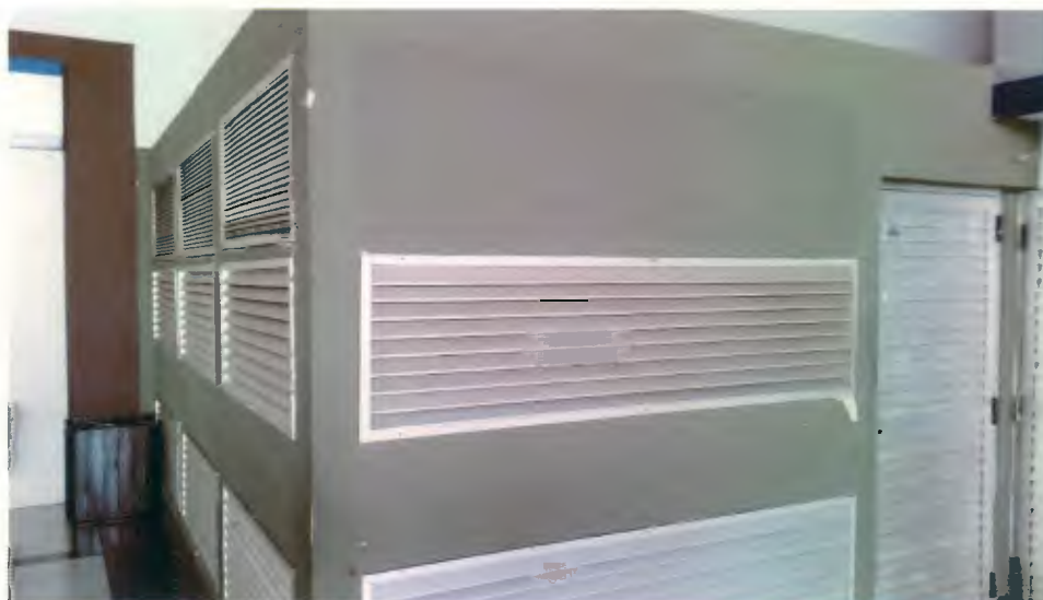
Imagem 18 – Casa de Máquinas do Ar Condicionado
