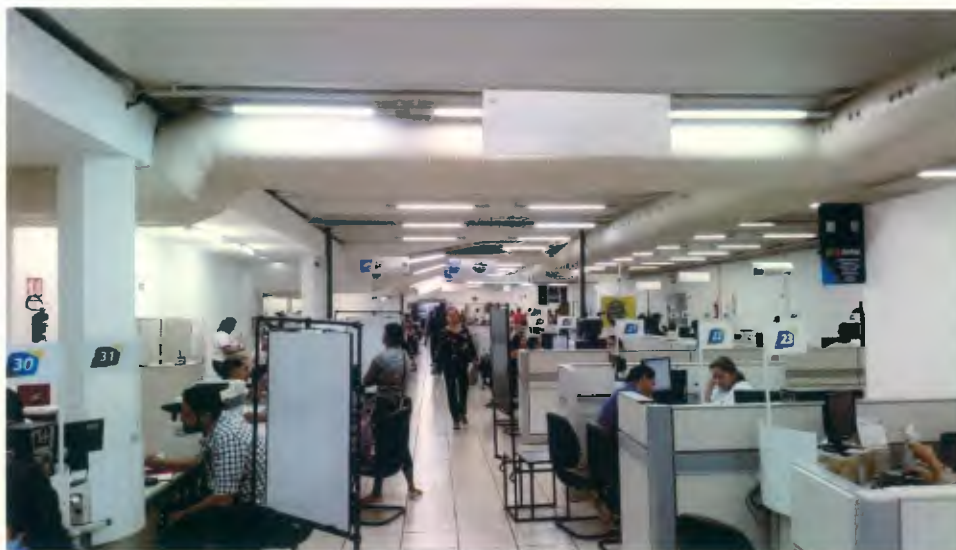
Imagem 17 – Dutos de Ar Condicionado
