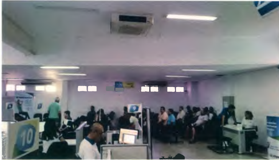
Imagem 20 – Ar Condicionado tipo Split Cassete e Split Normal
