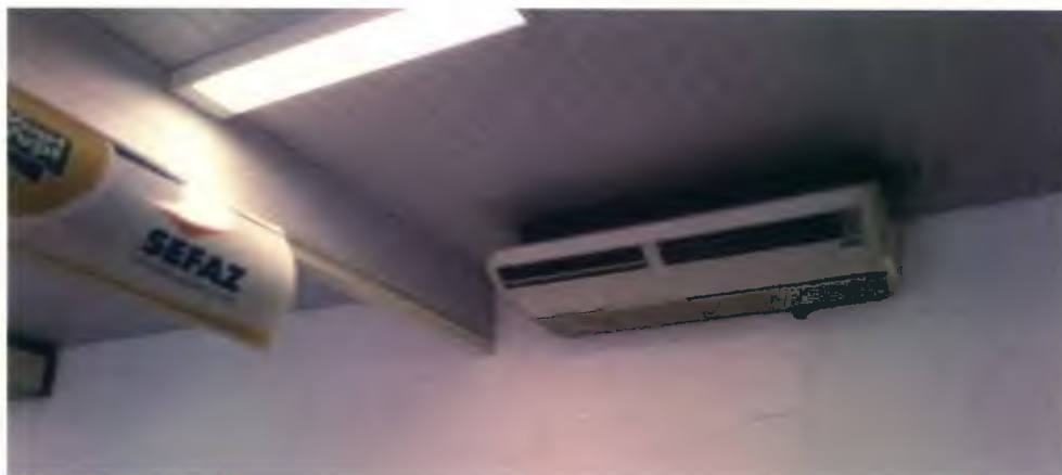
Imagem 33 – Sistema de climatização Split
