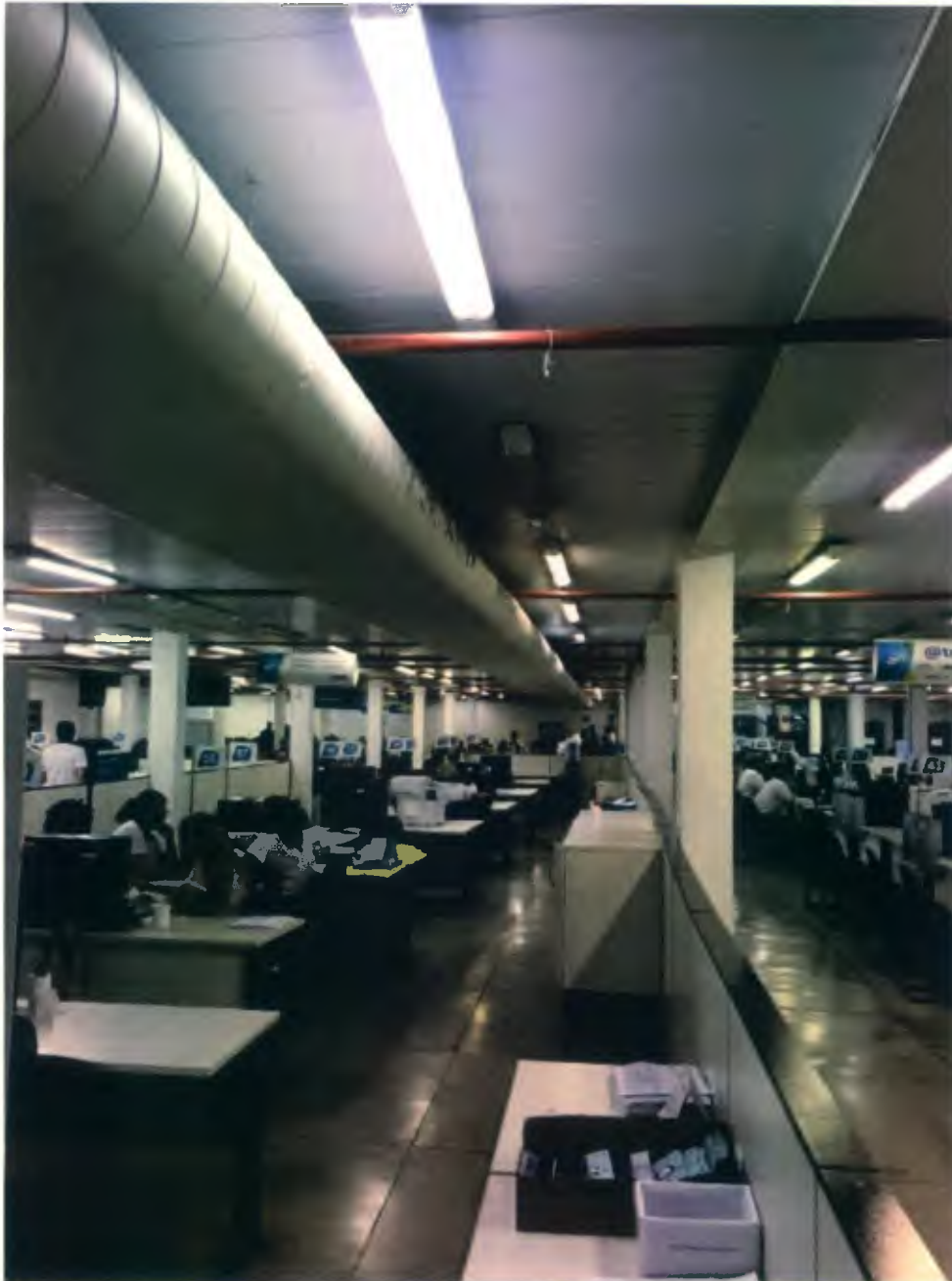
Imagem 22 – Dutos de ar condicionado – Área de atendimento
