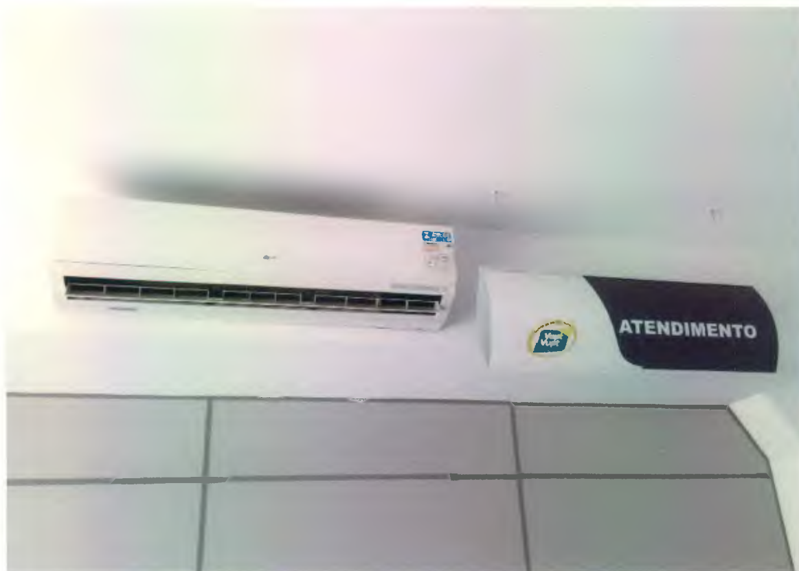
Imagem 16 – Ar Condicionado tipo Split Cassete e Split Normal
