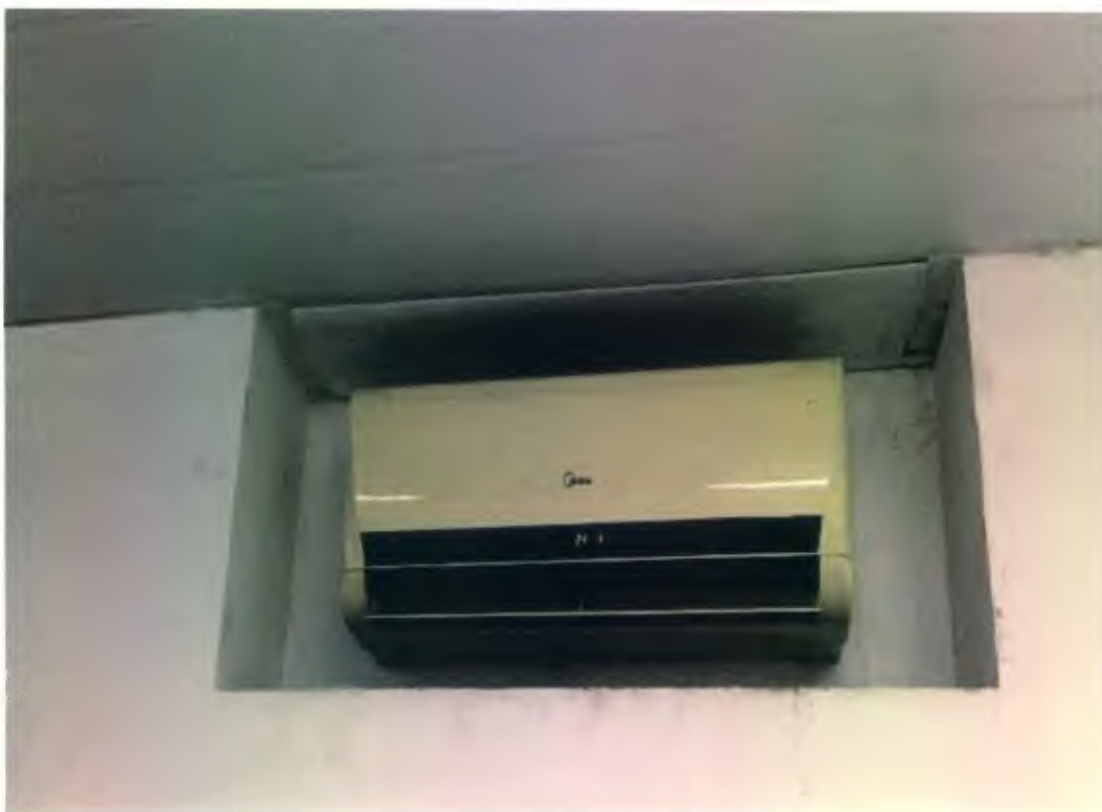
Imagem 21 – Ar Condicionado tipo Split em sala interna
