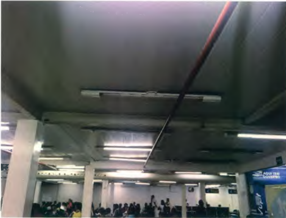
Imagem 15 – Forro em PVC
