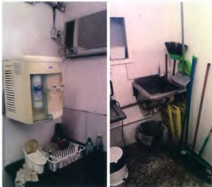
Imagem 21 – Instalações hidráulicas e elétricas na copa/área de serviço
