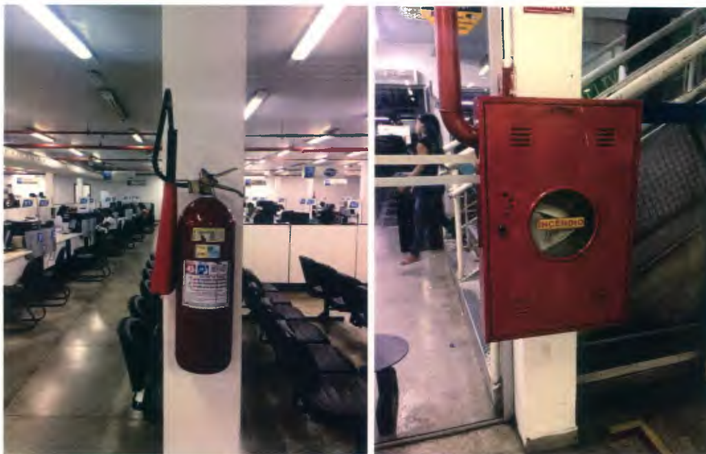
Imagem 20 – Extintor e Hidrante
