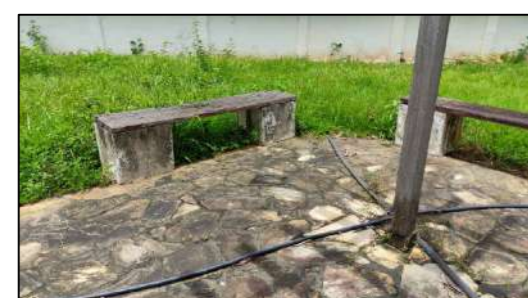
Foto 2 - Infiltração acendente e presença de microflora no chão.
