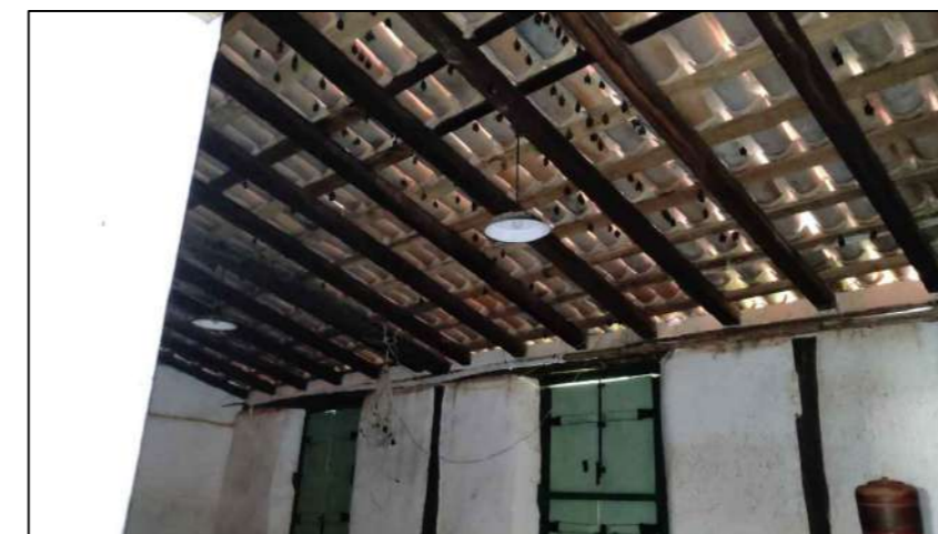
Foto 3 - Sujidade nas paredes, infiltração descendente e presença de animais.
