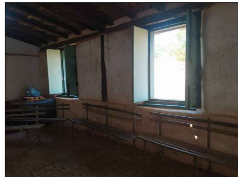
Foto 2 - Vista de sujidade nas paredes e infiltração acidentada.
