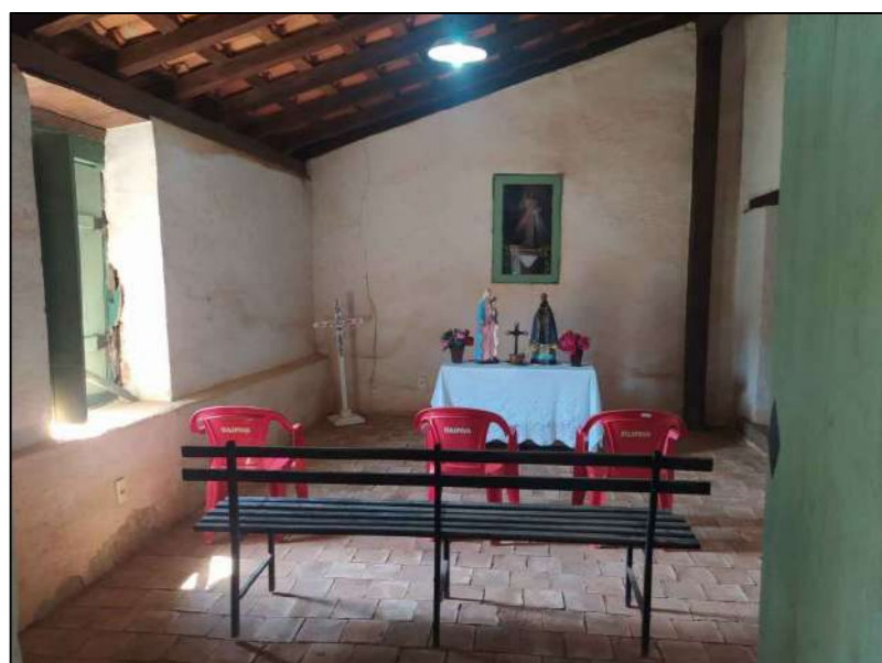
Foto 1 - Paredes com sujidade, trincas, deslocamento de pintura e perdas de partes na janela.
