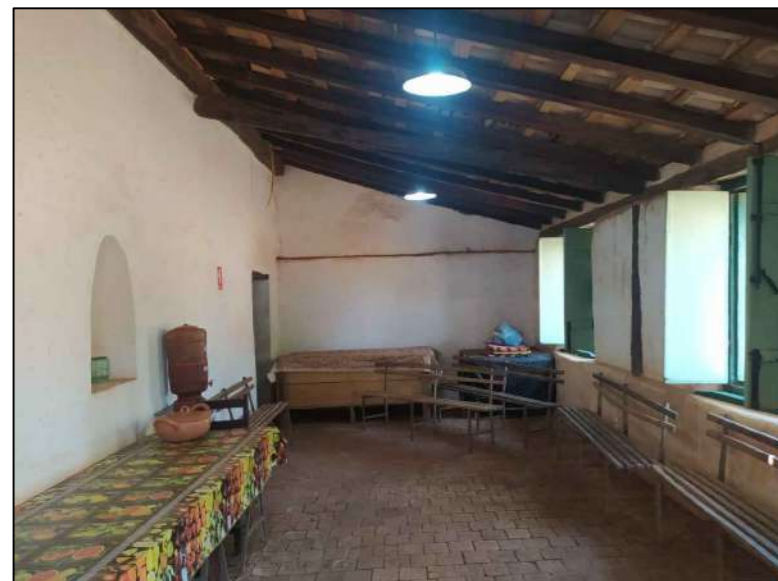
Foto 1 - Vista das sujidades nas paredes em geral e infiltração.
