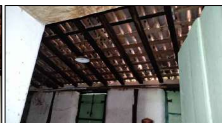
Foto 4 - Telhas quebradas e presença de animais..
