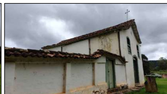
Foto 6 - Parede com sujidade, infiltração descendente e deslocamento de pintura.
