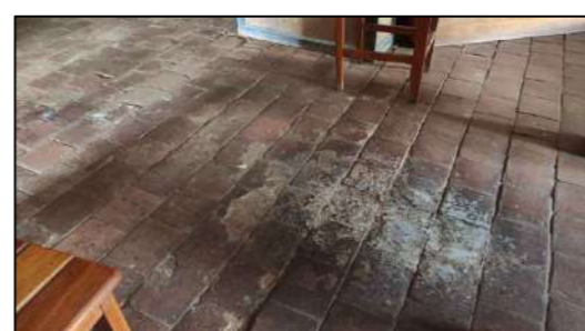
Foto 4 - Desgaste no piso mezaneta, desgastes causados por fezes de animais.
