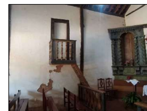
Foto 6 - Vista do pulpito, sujidade, trinca e deslocamento de pintura.
