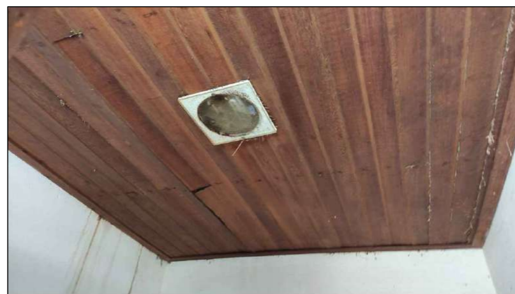
Foto 2 - Sujidade nas paredes, forro danificado e sujidade na luminária.
