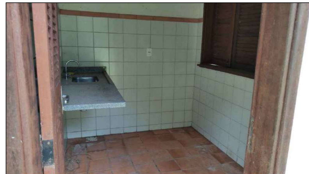
Foto 2 - Sujeidade nas paredes e no piso.
