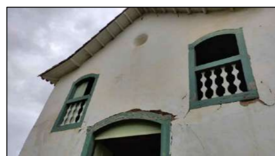
Foto 6 - Sujidade nas paredes, trinca, deslocamento nas pinturas e perda de partes.
