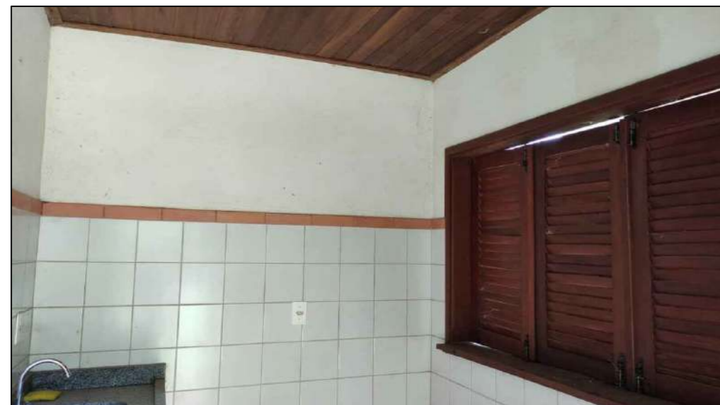
Foto 1 - Sujeidade nas paredes, infiltração descendente em cima da janela.
