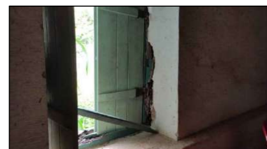
Foto 2 - Janela danificada, perda de partes.
