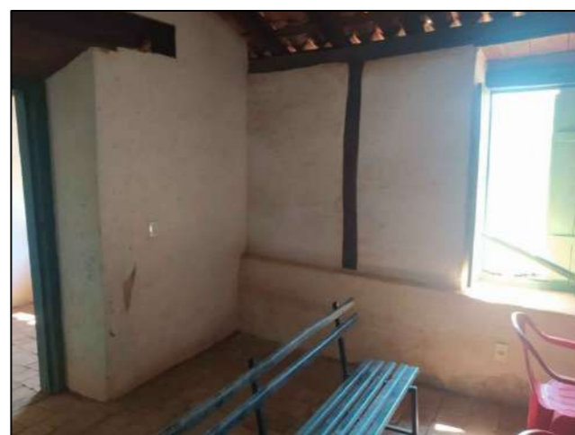
Foto 4 - Parede com sujidade e deslocamento de pintura.
