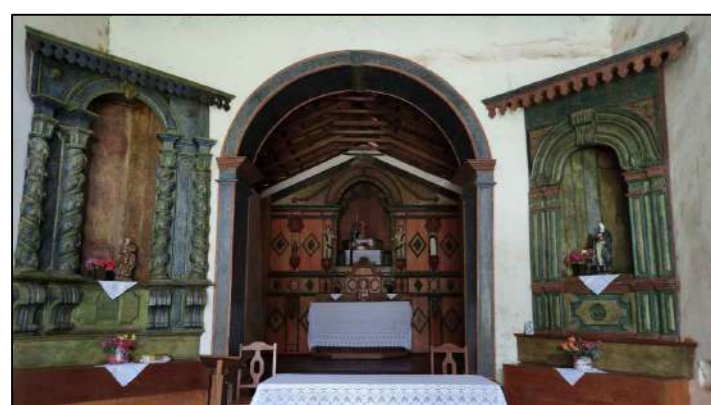
Foto 2 - Vista do altar desgastados, parede com sujidade.
