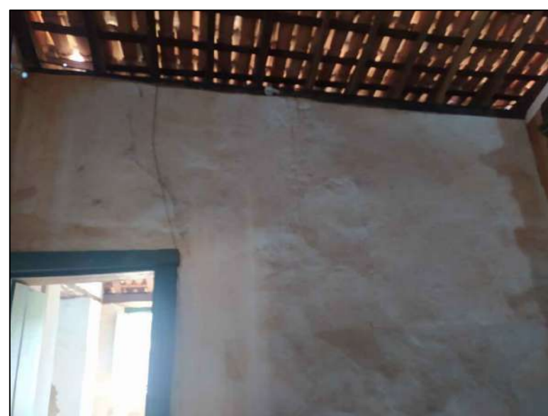
Foto 1 - Vista lateral esquerda com sujidade nas parede e trinca.
