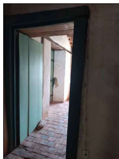
Foto 1 - Parede com sujidade e trinca.
