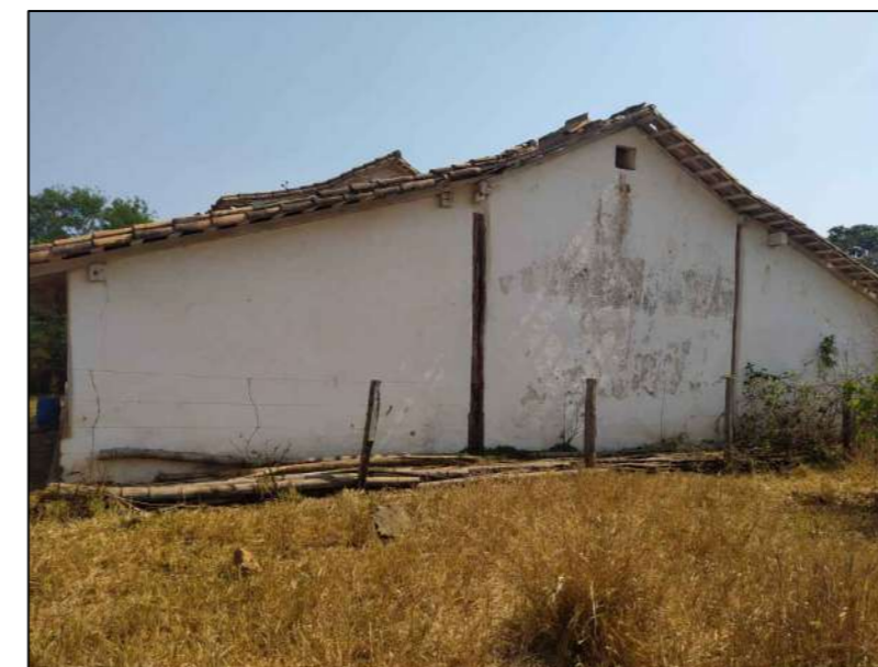
Foto 4 - Parede com sujidade, deslocamento de pintura, mancha escura e infiltração acidental e descendente.
