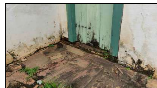
Foto 1 - Infiltração acendente e presença de microflora no chão.
