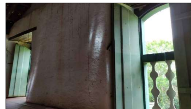
Foto 2 - Parede com sujidades e infiltração.
