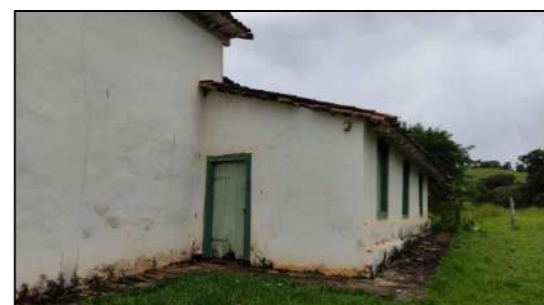
Foto 4 - Parede com sujidade, infiltração acidentada e deslocamento de pintura.
