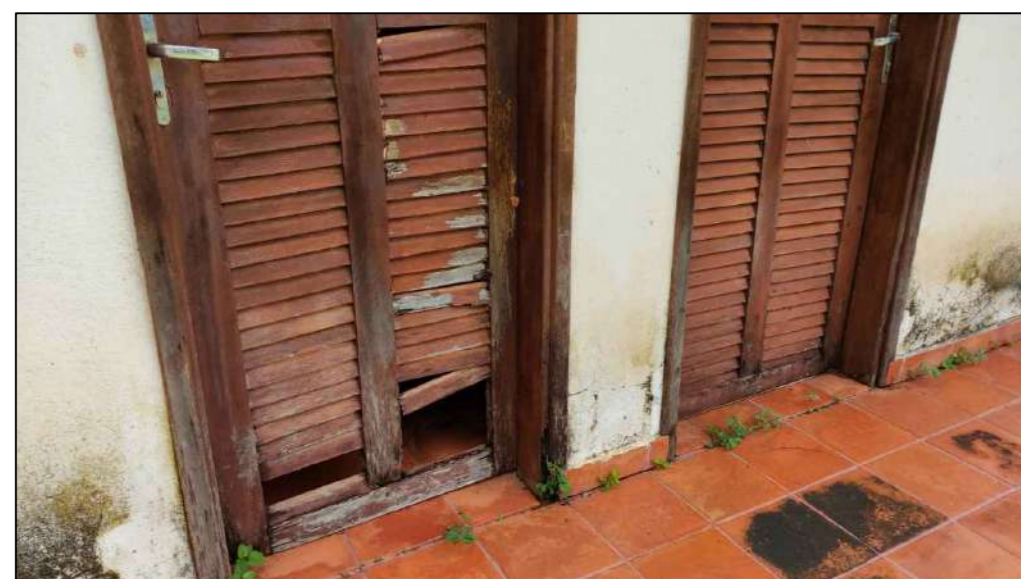
Foto 1 - Porta danificada com perdas de partes, presença de microflora no piso.
