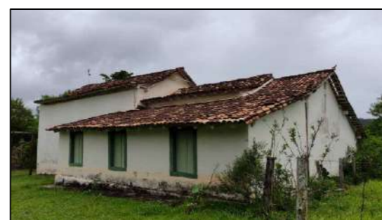
Foto 3 - Parede com sujidade, infiltração acidentada e deslocamento de pintura.
