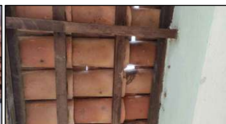
Foto 2 - Falta partes nas cobertura e telhas quebradas.
