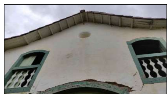
Foto 5 - Sujidade nas paredes, trinca, deslocamento nas pinturas e perda de partes.
