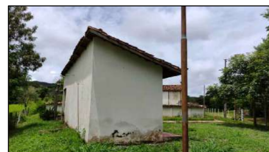
Foto 2 - Parede com sujidade e infiltração acidental.
