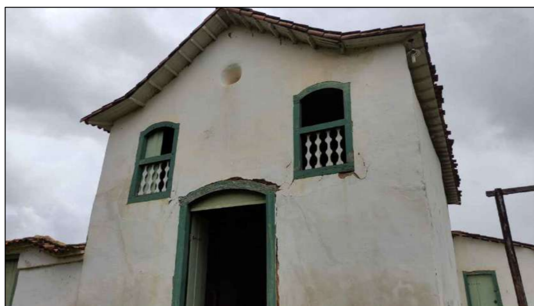
Foto 6 - Sujidade nas paredes, trinca, deslocamento nas pinturas, perda de partes e esquadrias danificada.
