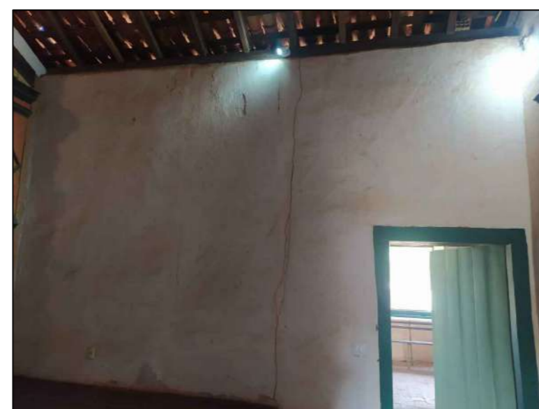
Foto 2 - Vista lateral direita com sujidade, deslocamento de pintura e trinca.
