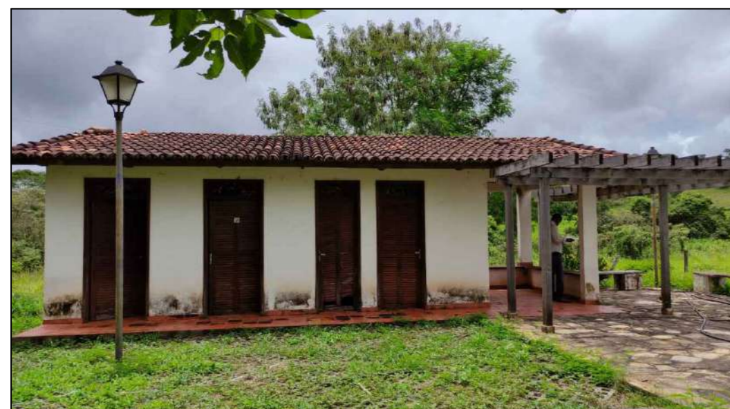
Foto 1 - Infiltração acidente, presença de microflora no piso, portas danificadas.
