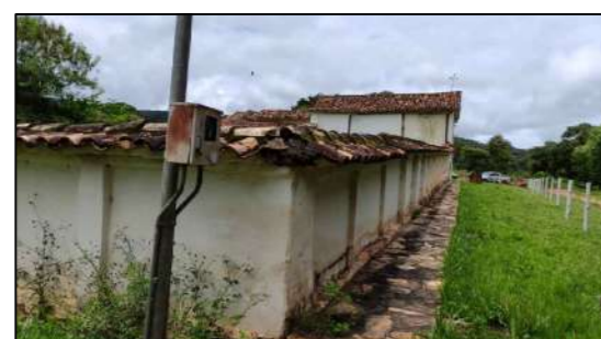
Foto 3 - Parede com sujidade, infiltração acidentada e presença de microflora no piso.
