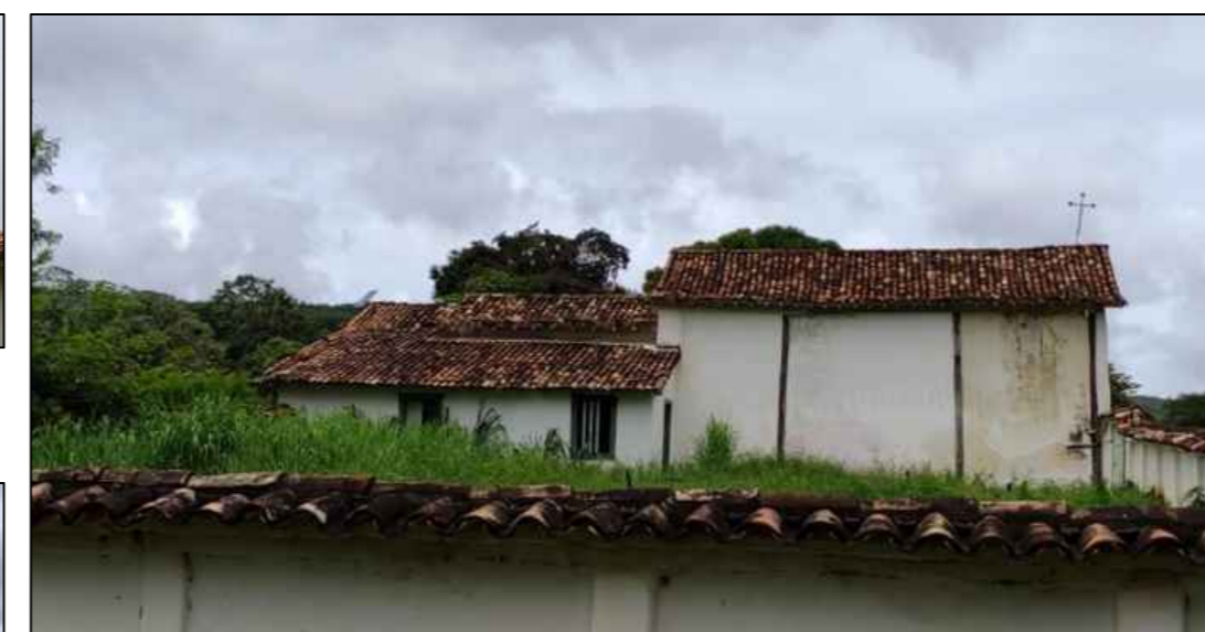
Foto 7 - Parede com sujidade, infiltração acidentada e descendente.
