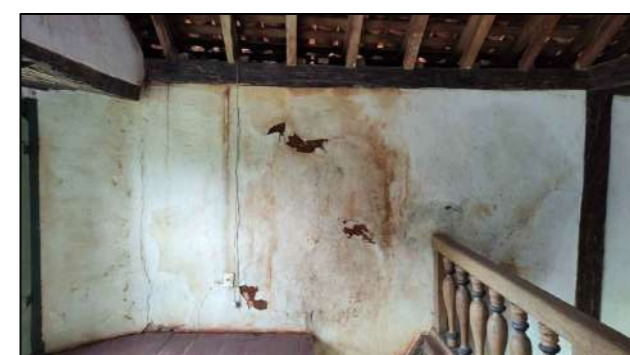
Foto 4 - Vista lateral do Coro com infiltração e trincas.
