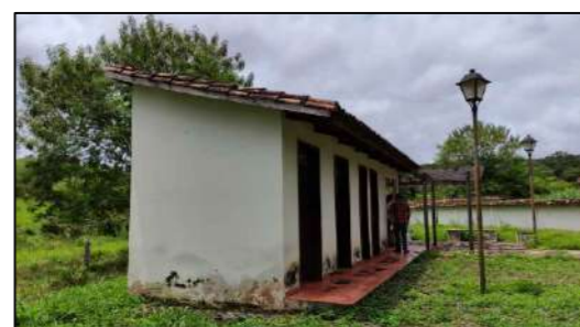
Foto 3 - Infiltração acendente e presença de microflora no chão.
