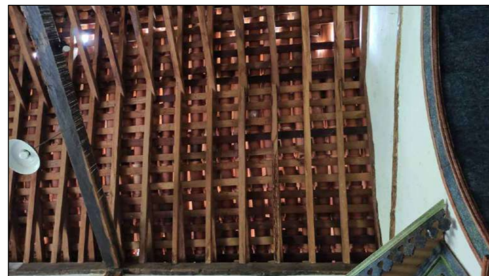
Foto 5 - Telhas quebradas, ausência telhas na cobertura.
