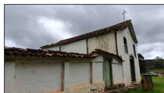
Foto 4 - Parede com sujidade, deslocamento na pintura e infiltração descendente.
