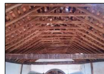
Foto 1 - Sujidade nas vigas por fezes de animais, falta telhas na cobertura.
