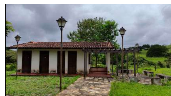
Foto 1 - Vista do anexo com sujidades, infiltração, cobertura destelhada.
