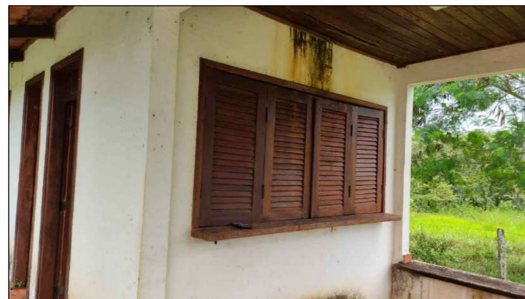
Foto 3 - Infiltração descendente em cima da janela e parede com sujidade.
