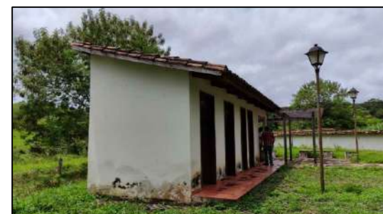
Foto 1 - Parede com infiltração acidental e presença de microflora no piso.
