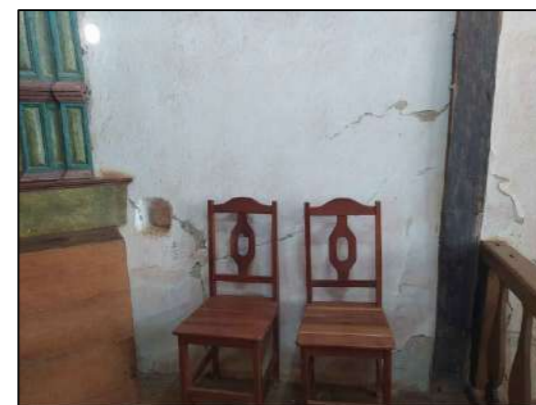
Foto 3 - Vista parede lateral com deslocamento de pintura, trincas e sujidade.
