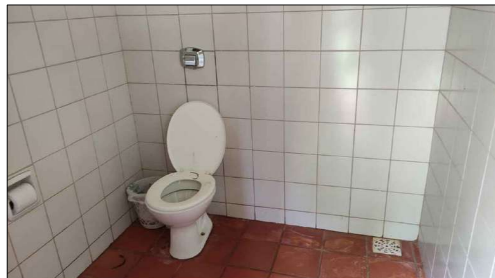
Foto 2 - Sujidade nas paredes, no piso e na bacia sanitária.
