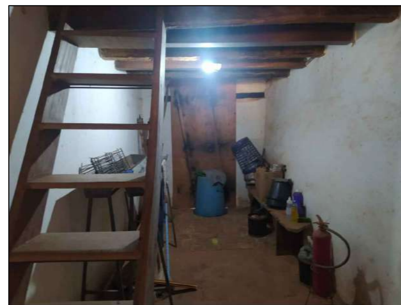
Foto 2 - Parede com sujidades e deslocamento de pintura próximo da porta.
