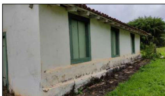
Foto 1 - Parede com sujidade, infiltração acidentada e deslocamento de pintura.
