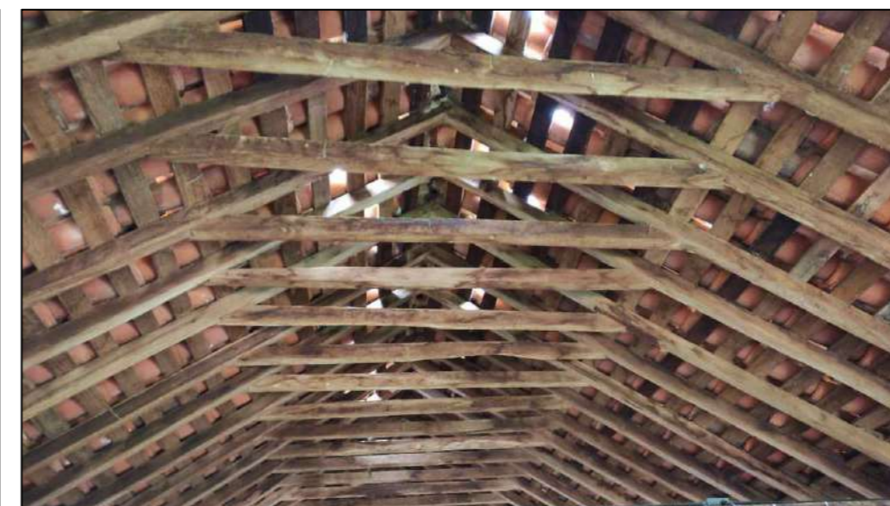
Foto 6 - Telhas quebradas, ausência telhas na cobertura.
