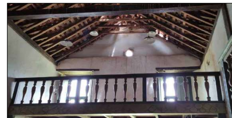
Foto 1 - Vista do Coro desgastado, parede manchada e perda de parte.
