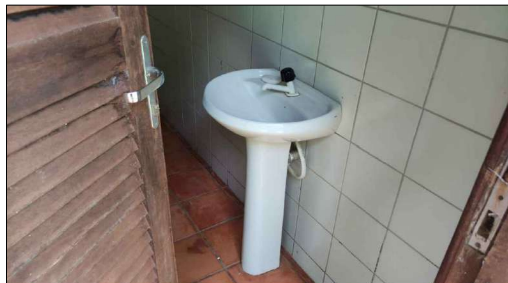
Foto 1 - Sujidade nas paredes e piso.
