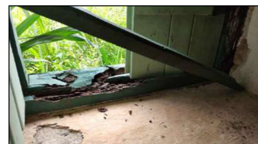
Foto 3 - Detalhe da janela danificada.
