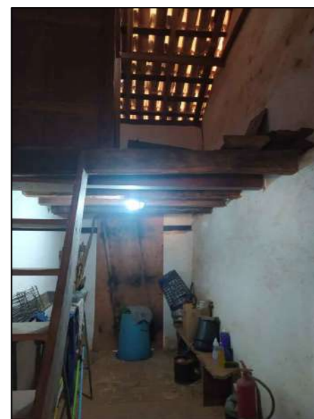
Foto 1 - Parede com sujidades.
