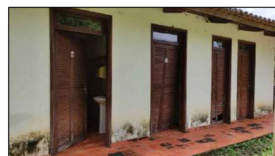
Foto 2 - Infiltração acidentada, presença de microflora.
