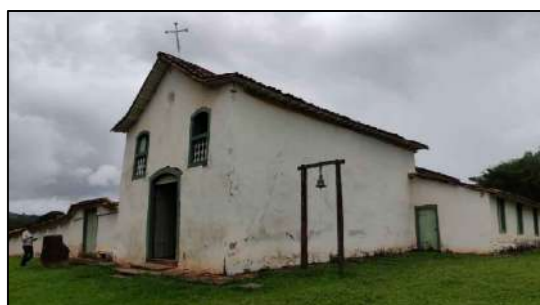
Foto 2 - Parede com sujidade, infiltração e trincas.
