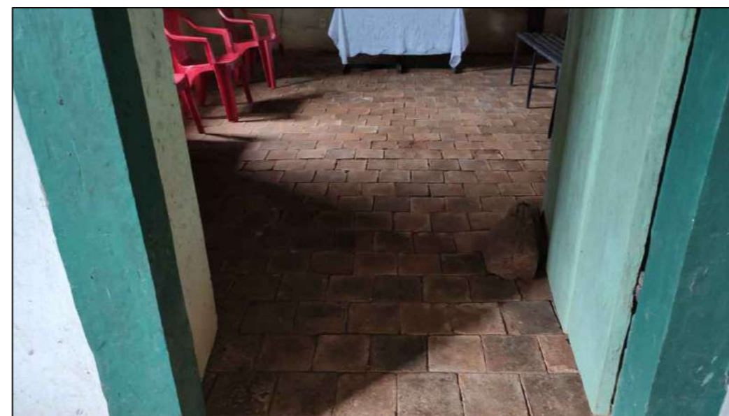
Foto 7 - Presença de desgastes no piso.
