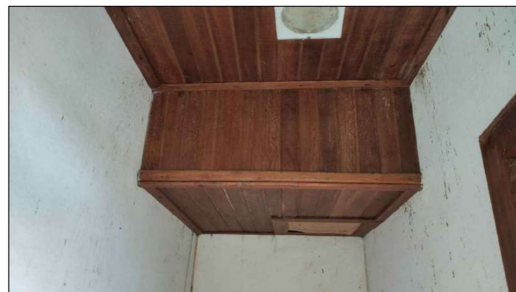
Foto 2 - Sujidade nas paredes, na luminária e no forro.
