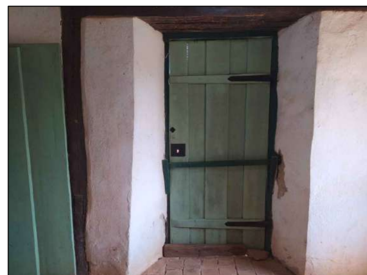
Foto 2 - Parede com sujidade, perda de parte ao lado da porta.
