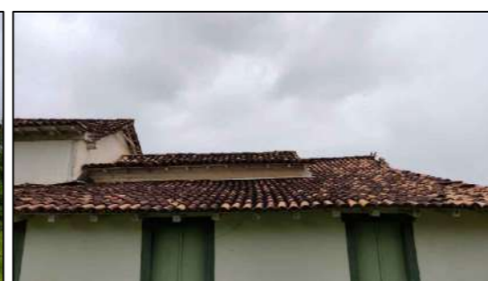
Foto 5 - Parede com sujidade, trinca e partes da cobertura destelhada.
