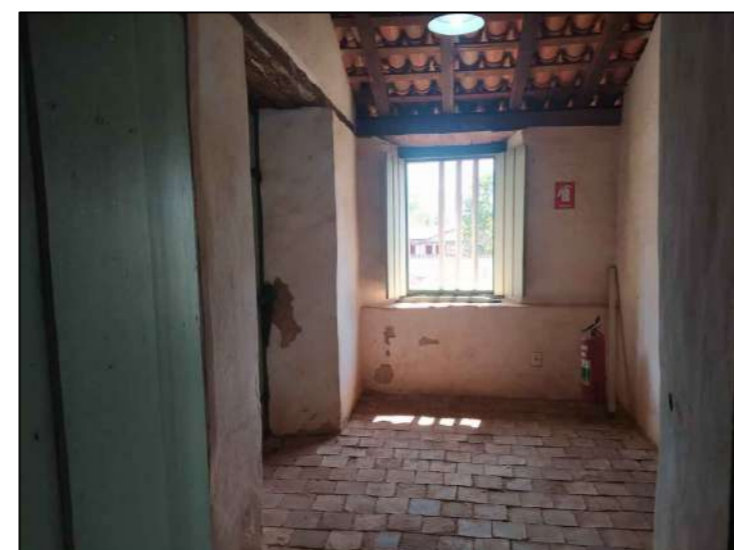
Foto 3 - Parede com sujidade, trincas e deslocamento de pintura.
