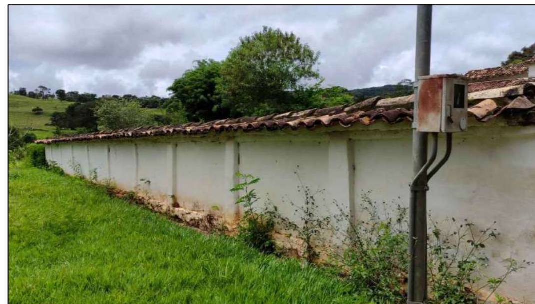
Foto 3 - Parede com sujidade, e infiltração acidental.
