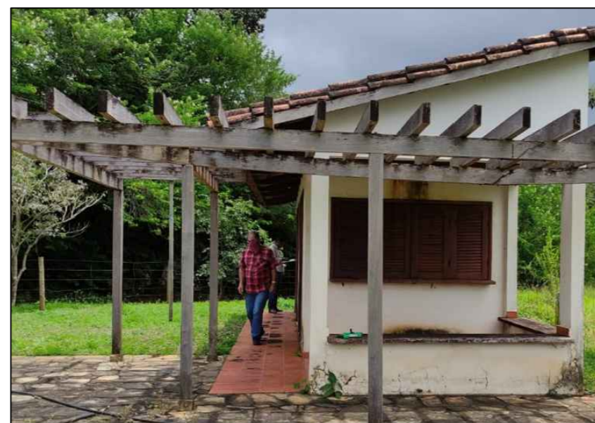
Foto 2 - Infiltração acendente, trinca e deslocamento na pintura.
