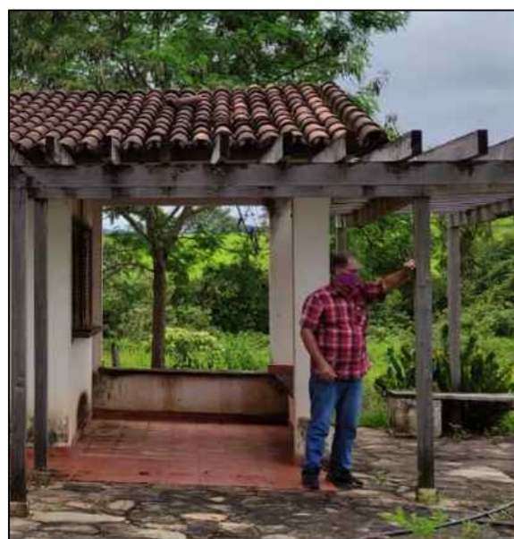
Foto 1 - Parede com infiltração acendente, microflora no piso.
